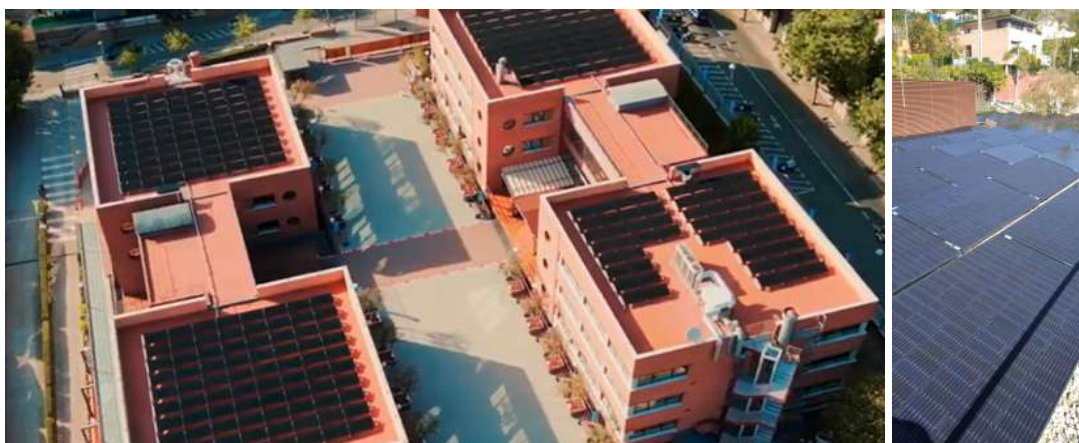
Imagen 1. Placas solares en los edificios del Campus Barcelona de la calle Iradier.
