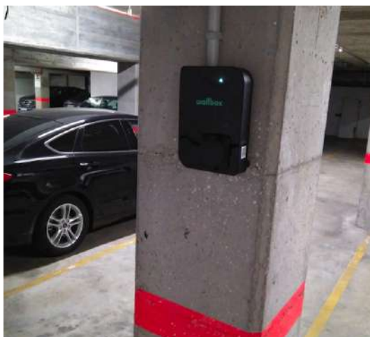
Imagen 12. Punto de recarga eléctrico
