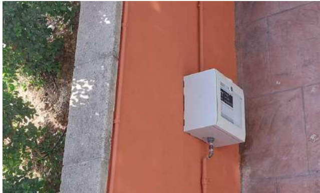
Imagen 10. Control de agua y riego para evitar fugas.
